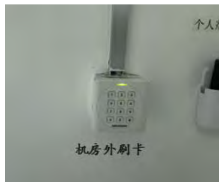
机房外门控按钮（需刷卡）
