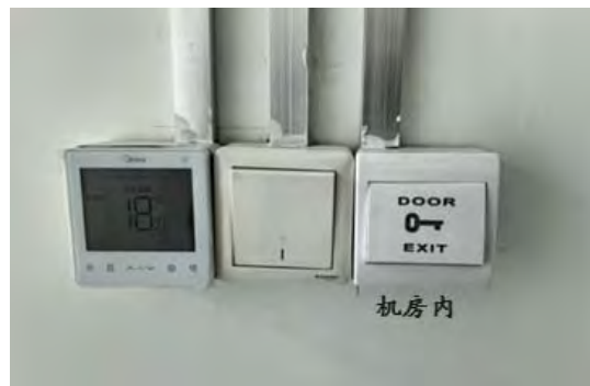
机房内开门按钮（只开门）
