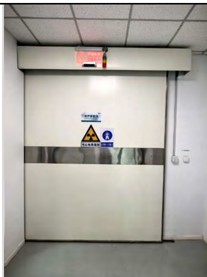
机房出入口放射性标志和中文警示说明， 工作状态指示灯
