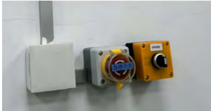
巡检按钮（南墙和迷道各设置 1 个）
