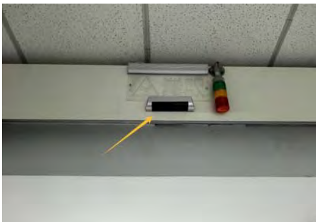
机房防护门防夹人装置
